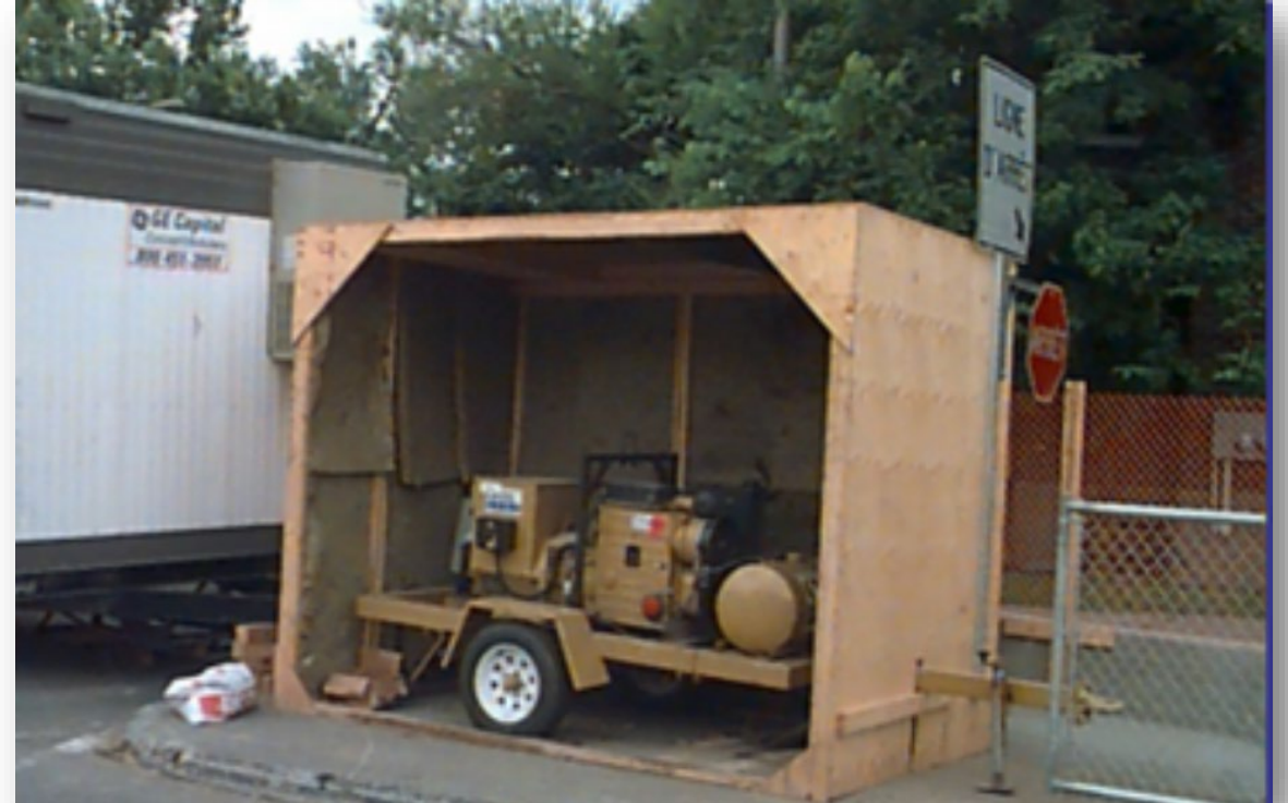
Mesures de mitigation pour les équipements bruyants
